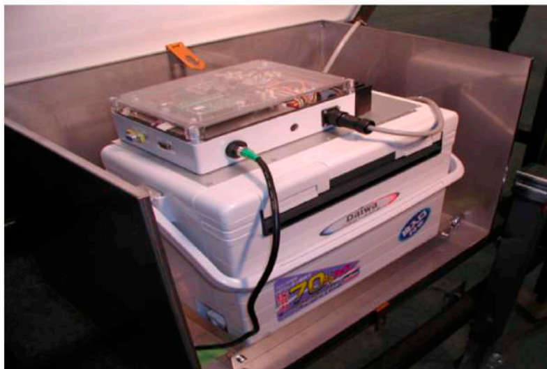
図 9: ステンレスボックスの内部 [15]。白いクーラーボックス内にはバッテリー、リポートタイマー、スイッチボードが格納されている。リポートタイマーは SD をリポートさせるための装置で、1 週間に 1 度強制的に作動するようになっている。スイッチボードはバッテリーからの電力の ON/OFF をする役割を持つ。クーラーボックスの上にはエレクトロニクスが固定されている。
