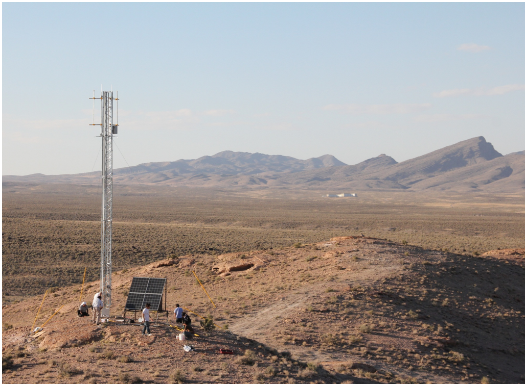
図 2.11: TALE 実験の SD アレイのための中央データ収集塔
