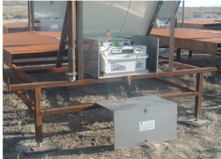
図 3.7: ソーラーパネルの下の箱にはエレクトロニクスとバッテリーが格納されている。L 字型の上蓋を開けた状態。
