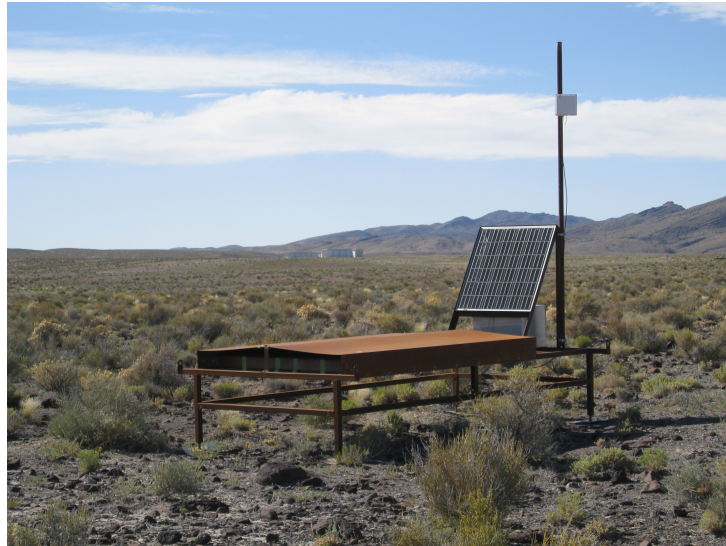
図 2.5: 現地に設置された TALE-SD の外観。
