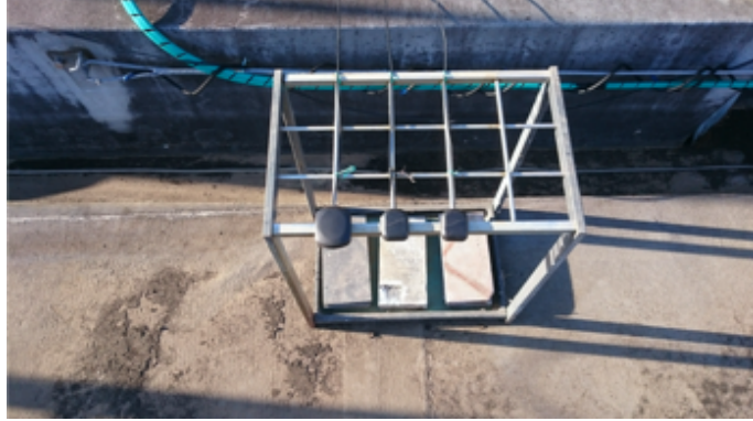
図 4.31: 屋上に設置した GPS アンテナ。フレームに乗せた 3 つの黒い色の GPS アンテナのうち、右のひとつのみ使用し、屋内の GPS Splitter で分割してサブ・ホストエレクトロニクスにそれぞれ接続した。
