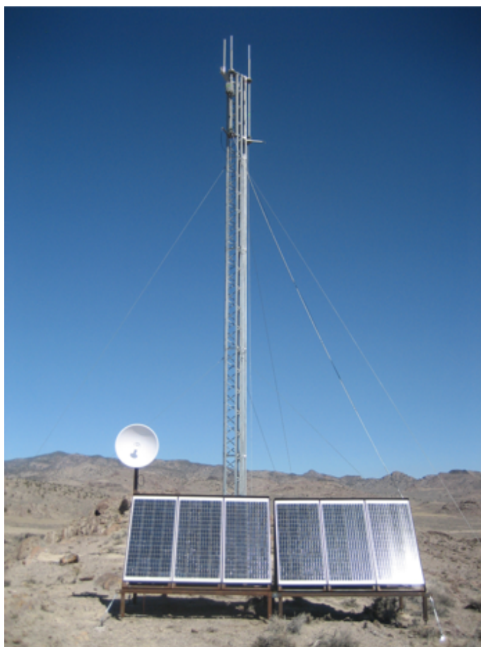
図 2.5: 通信塔 KMCT の外観。長距離通信用のパラボラアンテナ、ソーラーパネル、さらにソーラーパネルの裏に バッテリー、データ収集のための機器を格納するコンテナが設置されている。なお、これは後述の TA x4 用通信塔のうち KMCT(3.1.3 節) であるが、基本的に構成は TA と同じである。
