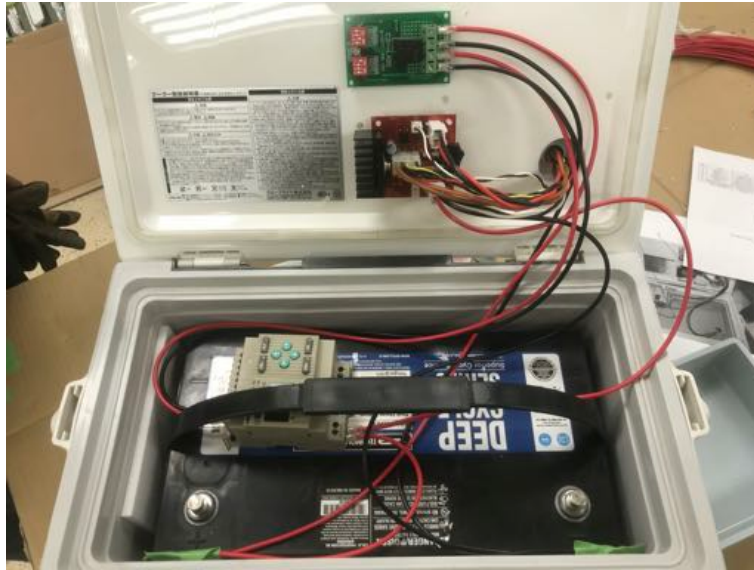
図 6.2: クーラーボックス内の配線。バッテリーには Reboot Timer、LVDM、スイッチボードが接続される。Reboot Timer は UTC で火曜日の 18 時に作動するように設定した。LVDM は 10.7V で Disconnect、11.4V で Reconnect するよう設定した。スイッチボードはエレクトロニクス側に接続されていて、バッテリーからの電力の ON/OFF が切り替えられる。また故障を防ぐためバッテリーの端子には SA 移動直前まで導線の接続を行わず、テープで覆った。
